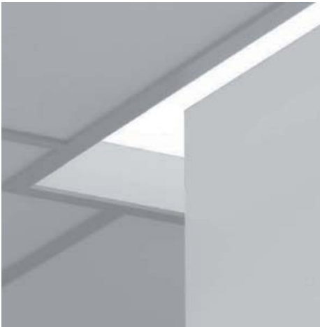
LUMINAIRE EN RETRAIT ASCENSEUR
